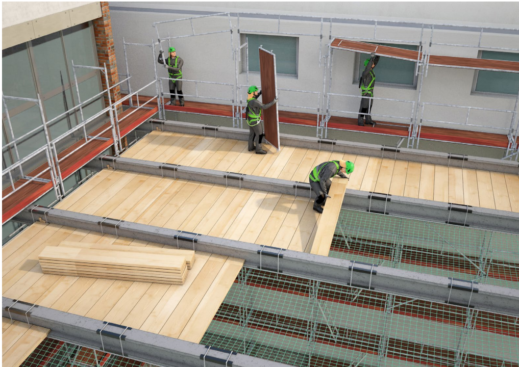
Abb. 8 Beispiel einer Auffangeinrichtung
